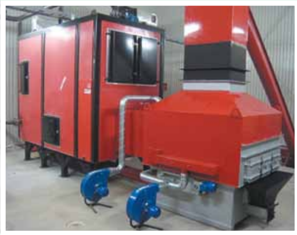
Panncentral 1.000 kw med askutmatning.
