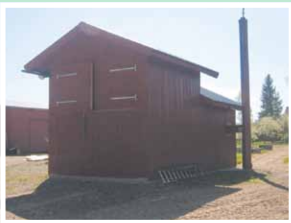
Fristående panncentral 100 kw sotning från markplan.
